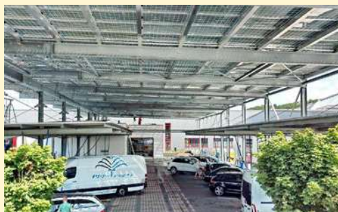
Solardach eines Waschparks in Tübingen
