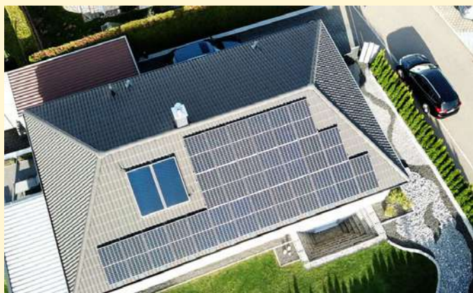
Photovoltaik-Module und zwei thermische Solarkollektoren auf einem Haus in Mengen. Solarkollektoren werden auf die Mindestfläche der Photovoltaik-Module angerechnet.
