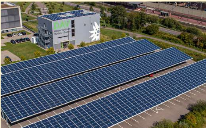
Park&Ride-Parkplatz der Stadtwerke Baden-Baden mit 371,3 kWp Photovoltaik
